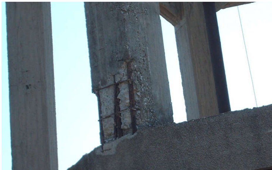
Φωτογραφία 3. Θραύση επικάλυψης λόγω οξείδωσης οπλισμού.
