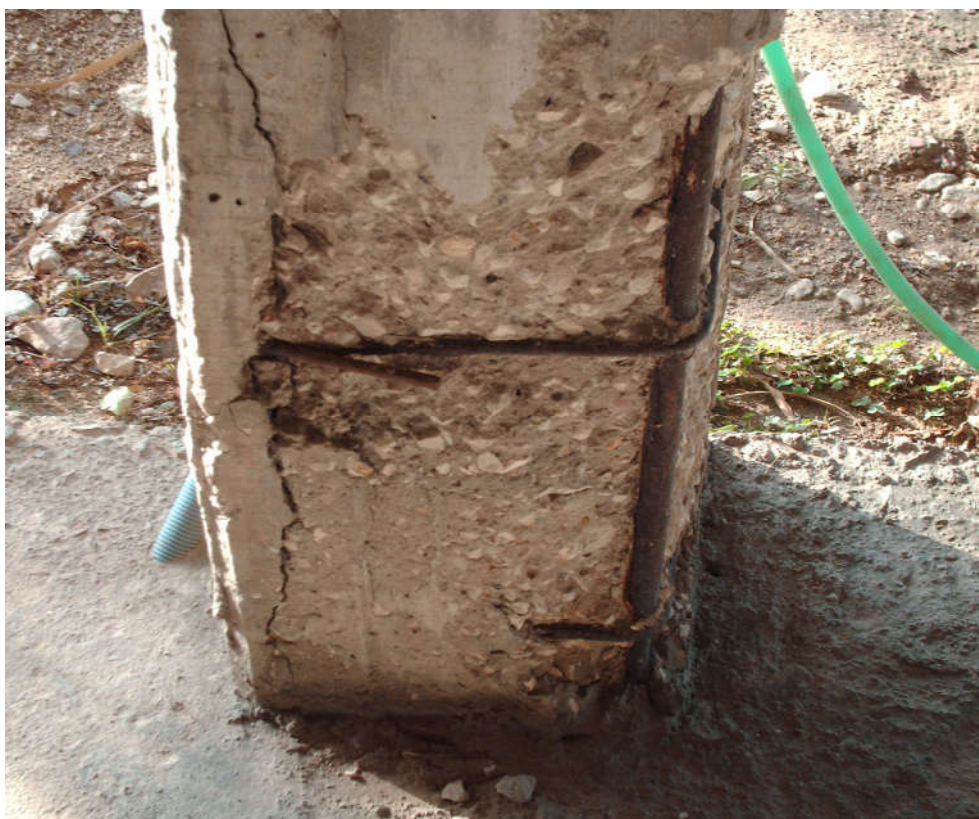
Φωτογραφία 2. Θραύση επικάλυψης λόγω οξείδωσης οπλισμού.
